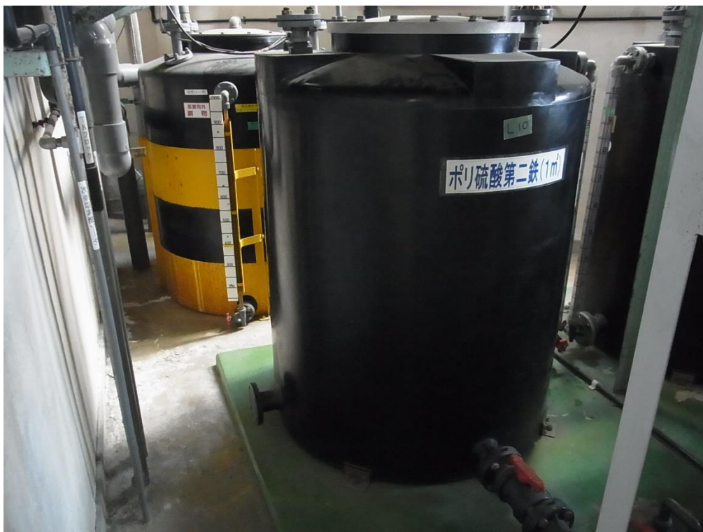
○写真 6. 小出しタンク全景
