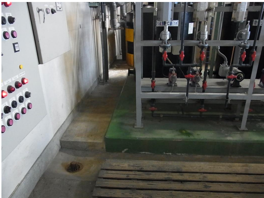
○写真 8. 小出しタンク排水溝
