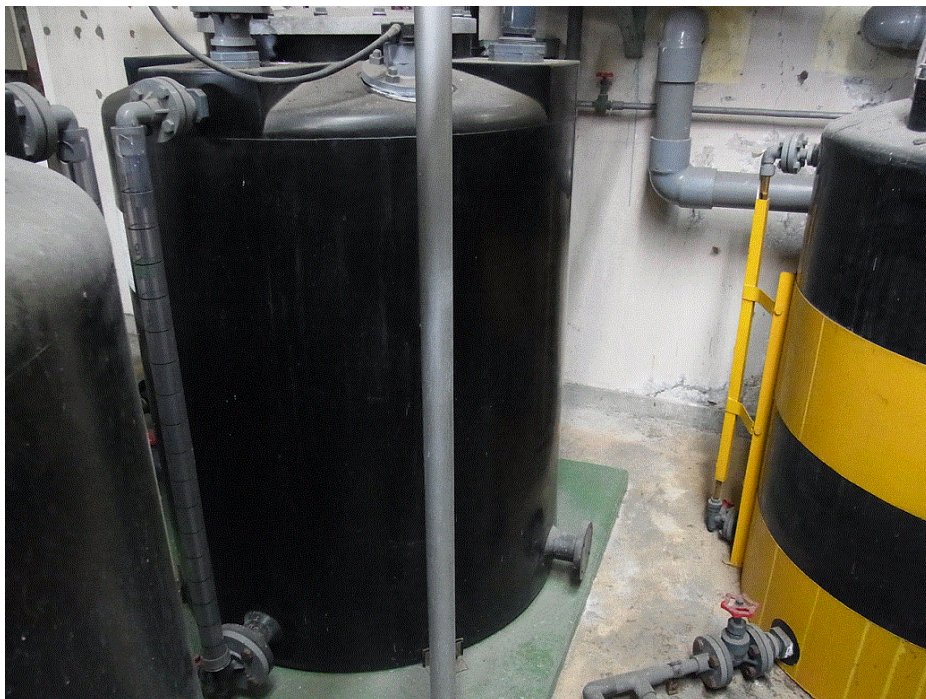
○写真 7. 小出しタンク裏側
