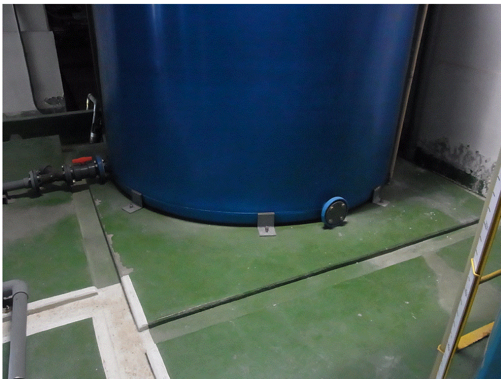
○写真 2. 貯蔵タンク（裏側）
